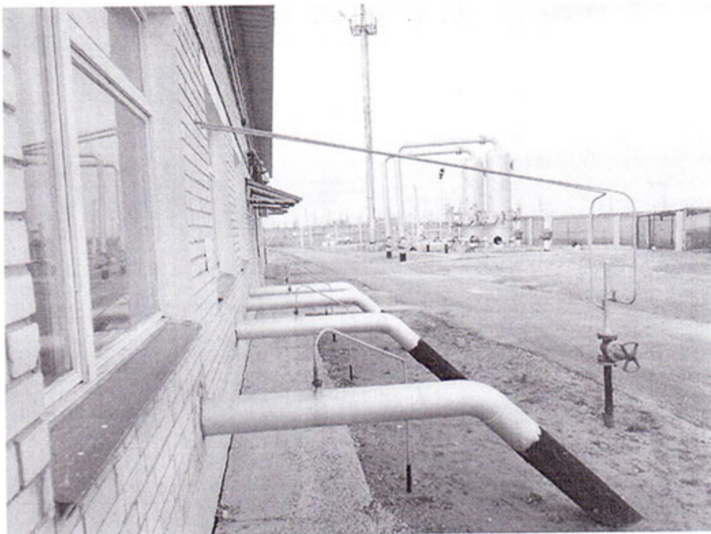
Точки подачи метанола на входных участках газопроводов
